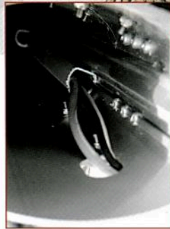
Dans le mât, les câbles électriques sont isolés dans des gaines en PVC.
