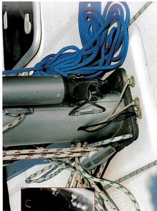
Des connexions électriques de pied de mât sans protection en standard, indignes d'un grand constructeur.
